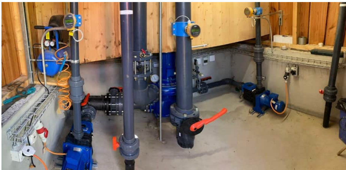
Abbildung 16: Technikraum mit Pumpen für Kleinkinderbad, Hauptbad und Skimmer im Regenerationsbereich, 08.07.2021
