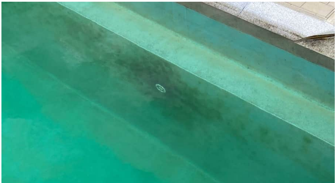
Abbildung 17: Düsen mit seitlichen ausströmenden Schlitzten führen zu verstärkter Anströmung der Folien-Oberflächen und somit zu verstärkter lokaler Biofilmbildung, 16.09.2021
