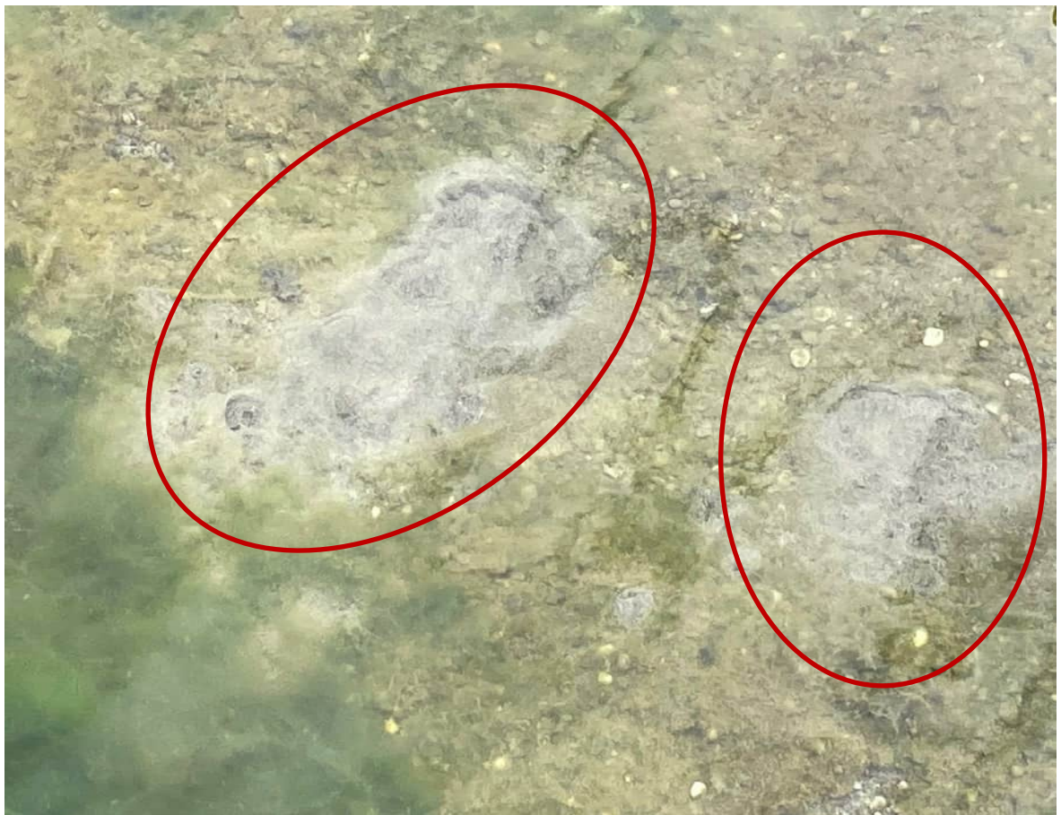
Abbildung 12: Sichtbare Filterdurchschüsse druckseitig, 19.08.2021
